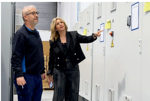
Wissen, was läuft: Geschäftsführerin Judit Birosta im Gespräch mit ihrem Mitarbeiter Antonio Martín im Schaltanlagenbau.
