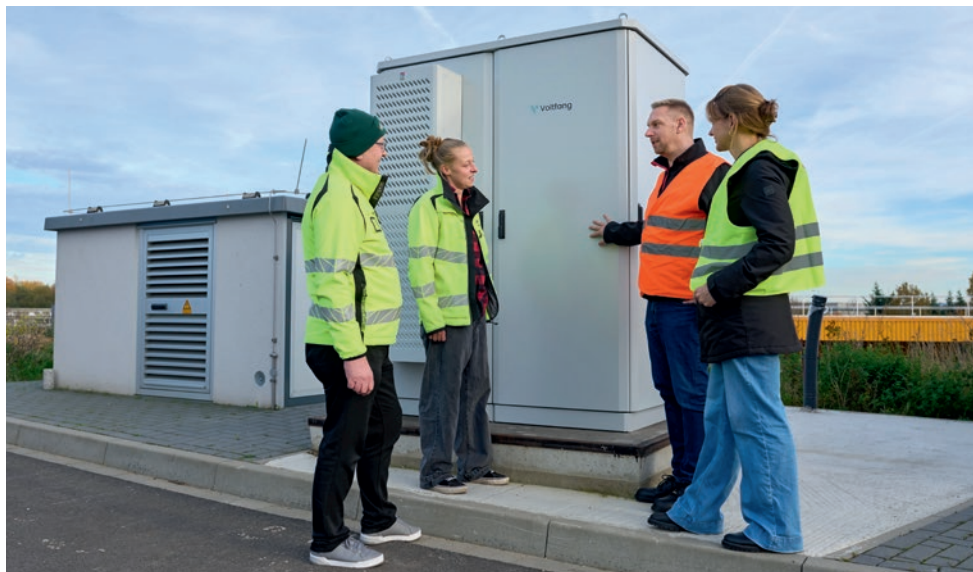
Auf einem eigenen Fundament errichtet, leistet der Speicher von Voltfang bei AWA verlässlich seinen Dienst.
