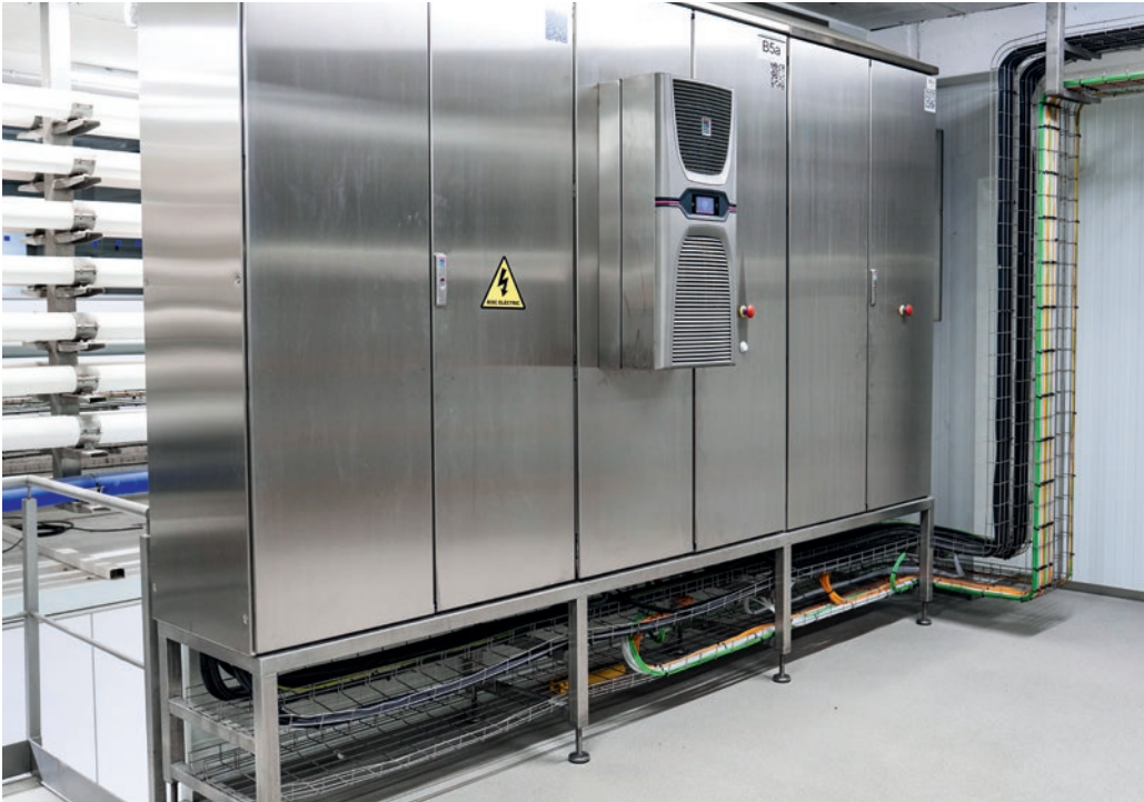
Bei Liquats Vegetals kommen auch die Rittal Kühlgeräte zum Einsatz.
